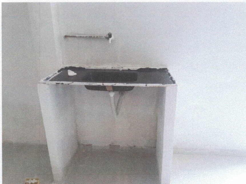
Figura 5: Pia de amianto
